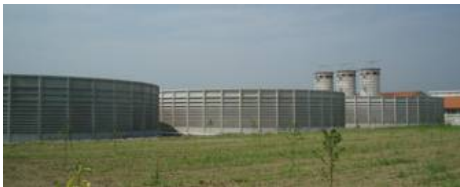
● La suddivisione del volume di stoccaggio in più vasche migliora l'elasticità di utilizzo, facilita l'omogeneizzazione del contenuto e conferisce maggiori garanzie igienico-sanitarie.
